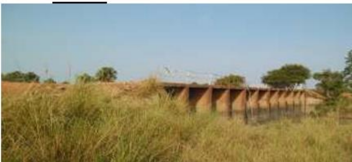
Dalots multiples d'état vétustes à remplacer
