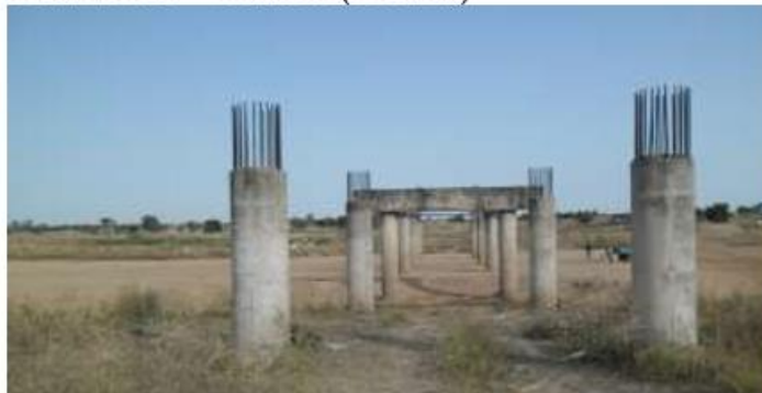
Pont inachevé sur la rivière de BIANKOURI situé dans l'emprise de la piste
