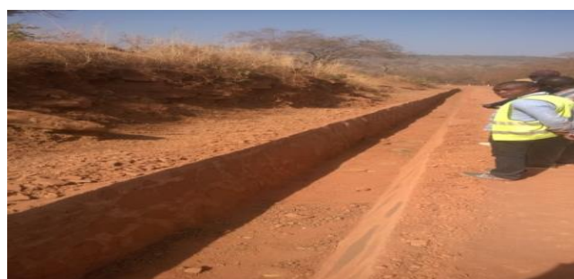
Caniveau en moellon PK 1+700
